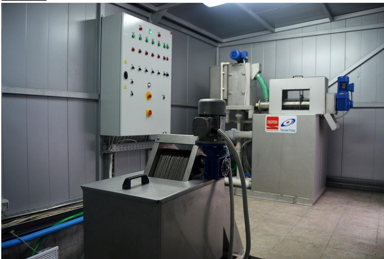
Фиг.54. Съоръженията от механичното пречистване на отпадъчните води в модулната пречиствателна станция. На преден план е механичната решетка за фино пречистване. На заден план е дехидратора за обезводняване на утайките
